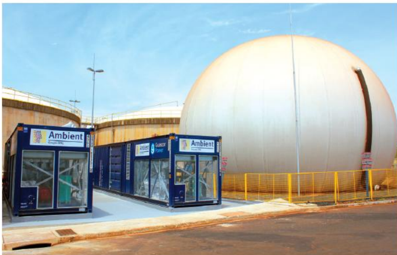
Implantação do novo gerador de energia através do biogás
